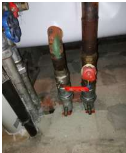
Vannes isolées en pied de colonnes
