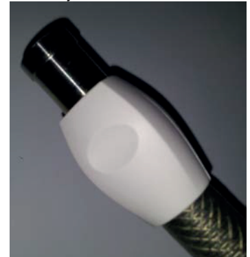
Branchement coté prise gaz
