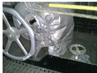
Manchon isolant spécial sur vanne vapeur 12 bars
