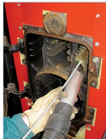
Nettoyage d'une chaudière standard
