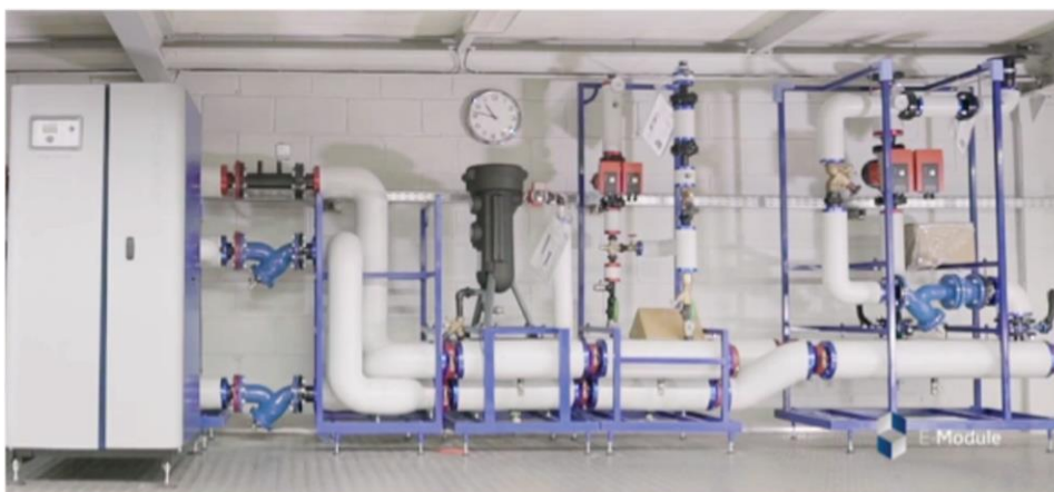
Aperçu visuel de la chaufferie avec les modules préfabriqués
