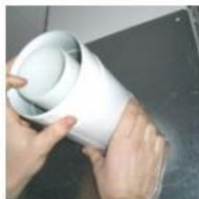
5. Pose du raccord concentrique d'amenée d'air comburant et de la plaque d'étanchéité
