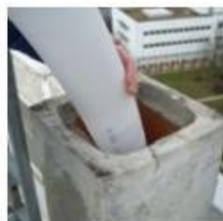
2. Introduction du tubage (ici en PP Ø 80) et mise en place des fixations, supports, centreurs
