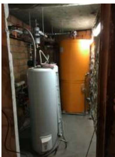
Ballon électrique avec ballon de stockage au second plan
