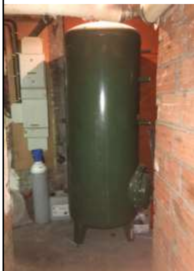
Ballon de stockage livré et stocké au sous-sol
